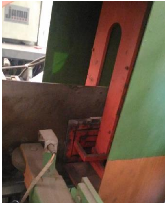
Figura 67 - Perfil montado passando pelas placas de indução.
